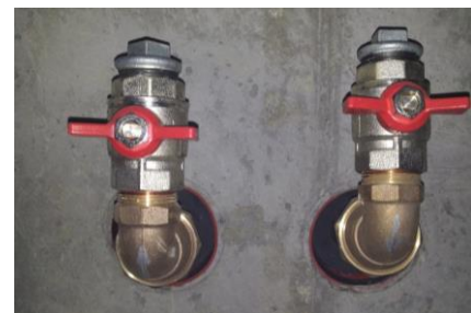
2 Kugelhähne nach Wanddurchführung als Schnittstelle
